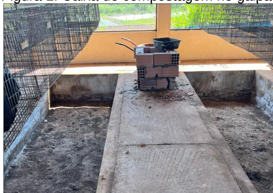
Figura 1. Caixa de compostagem no galpão
